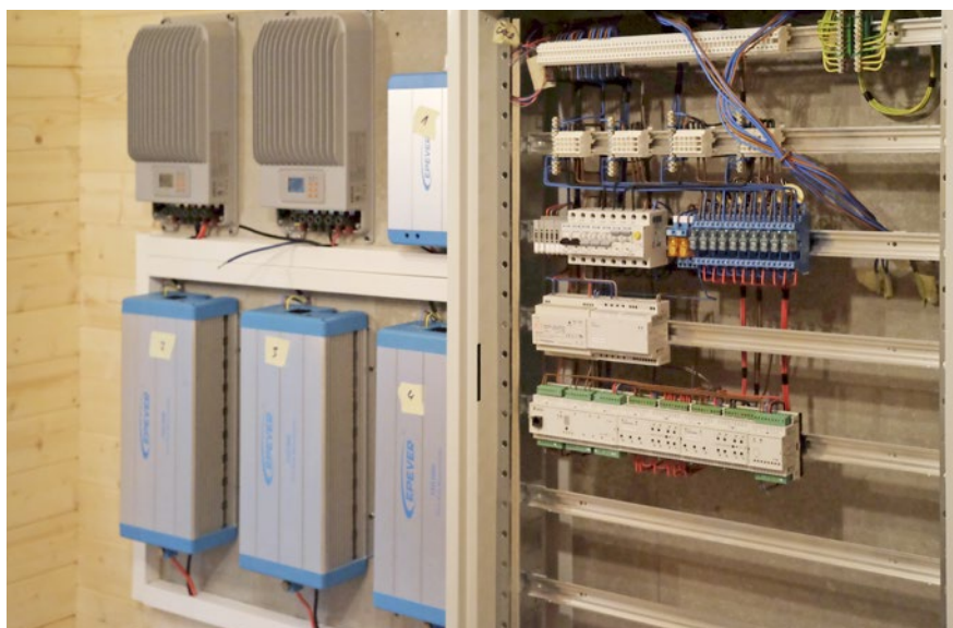
Obr. Rozvaděč s Foxtrot v technické místnost. Na stěně vedle moduly nabíjení a střídače pracující z baterií.
