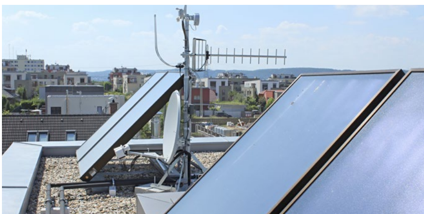
Obr. Střecha rodinného domu je nedílnou TZB. Je další technickou „místností“ s nainstalovanými solárními termickými panely, meteostanicí a komunikačními anténami pro spojení se světem.
