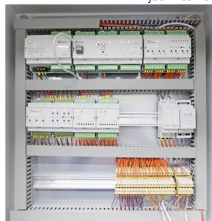
Obr. Rozváděč s Foxtrotem instalovaný ve firmě VIPAX.
