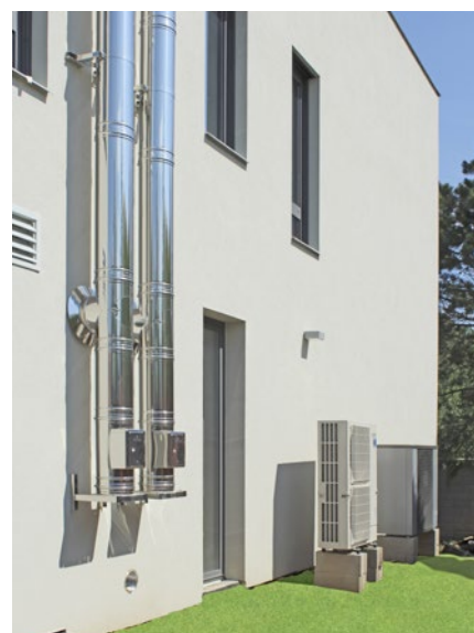
Obr. Venkovní jednotka tepelného čerpadla je umístěna před domem na jižní straně. Kominová tělesa vedená na fasádě jsou od bivalentního zdroje zapínaného při nejnižších okolních teplotách.
