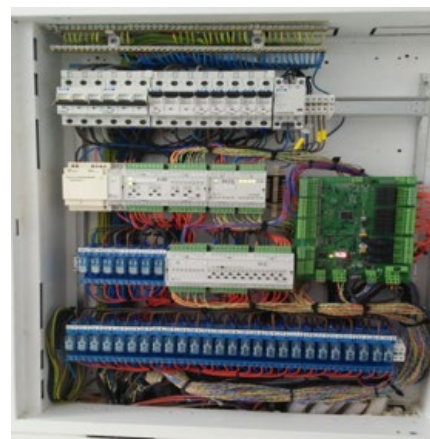
Obr. 1. Pohled do rozvaděče řídicího systému Smart Control, který je vyvíjí a dodává firmou TENAUR s. r. o. Na pravé straně je OEM verze Foxtrotu v „Open Frame“ provedení se speciálně sestavenou konfigurací vstupů a výstupů pro řízení tepelného čerpadla. Je kombinována se standardními rozšiřovacími moduly.
