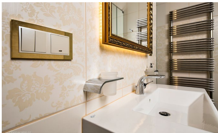
Obr. Nástěnné ovladače v koupelně obsahují i senzor teploty. Ovládáno jak podsvícení zrcadla, tak vytápěcí žebřík. Apartmán je navíc osazen větším počtem zásuvkových okruhů, více spínanými světelnými a několika stmívanými okruhy s RGB LED pásky. Dále je osazen několika podlahovými konvektory přímo řízenými výstupy systému Foxtrot.
