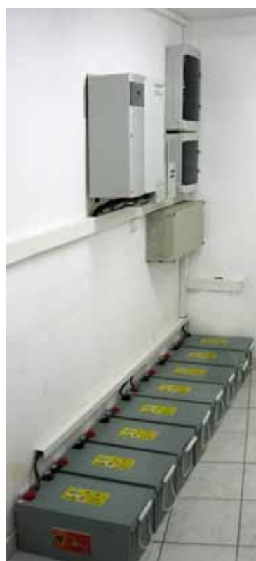
Obr. 3 Akumulátorovna rodinného domu; literatura uvádí, že budoucí optimální akumulací kapacita pro rodinný dům bude okolo 10 kWh
