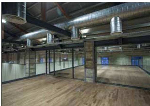
Obr. 3. Interiér muzea před instalací exponátů; pro jejich uchování je důležité nejenom správné osvětlení, ale i vzduchotechnika; přiznané technické zázemí nechává viditelnou původní konstrukci stavby a střechy
